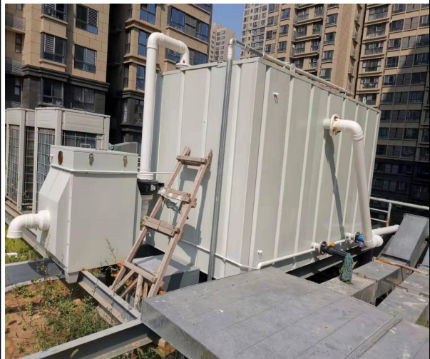
一体化污水处理设施
